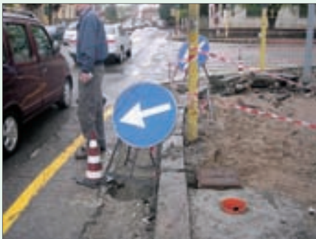
Situazione non regolare, la chiusura del marciapiede costringe i pedoni ad andare sul ciglio della strada senza protezione
